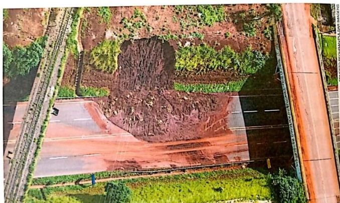
Queda de barreira em estrada próxima a Arapongas, Paraná, em 2016.
